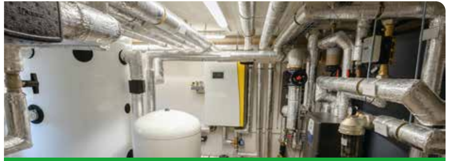
Zu Besuch in der Doberluger Straße 9-11 in Tröbitz – einem unserer vier Bestandsobjekte mit frisch installierter Wärmepumpenanlage.
