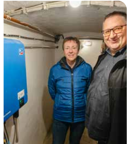
Susanne Böhm und Steffen Horn begutachten den Wechselrichter, der zusammen mit der neuen Photovoltaikanlage Einzug in das Wohnhaus in der Friedrich-Engels-Straße hielt.
